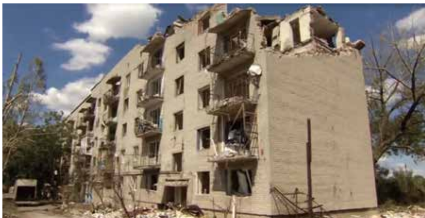
Ein durch einen russischen Drohnenangriff zerstörtes Wohnhaus
